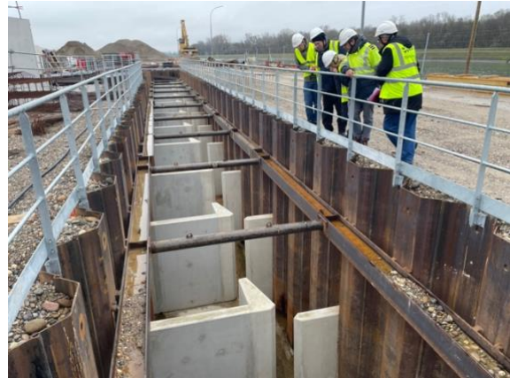
Die Fischtreppe am Kraftwerk Rhinau zum Oberwasser ist fast fertig und wird genau unter die Lupe genommen.
