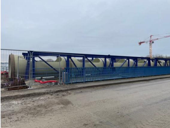
Am Kraftwerk Rhinau ist die Galerie schon errichtet. Damit werden die Fische von einer Kanalseite auf die andere geleitet und über den Mitteldamm ins Oberwasser.
